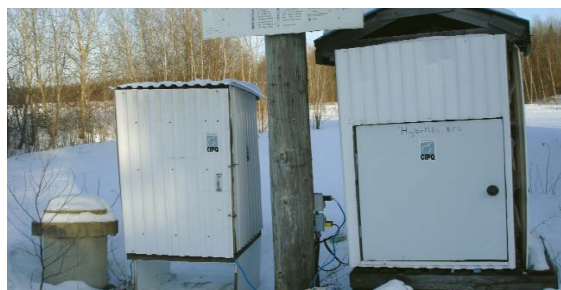
Réception dans boîte isolée et chauffée (chaufferette avec ventilateur).
