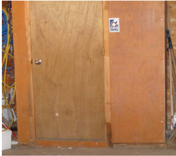
Portique isolé et chauffé à l'intérieur d'un entrepôt non chauffé.
